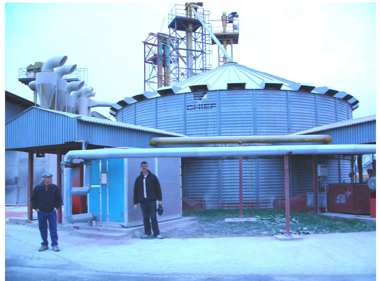
Obr.3 Pohľad na výmenník tepla Fig.3 View of the heat exchanger
