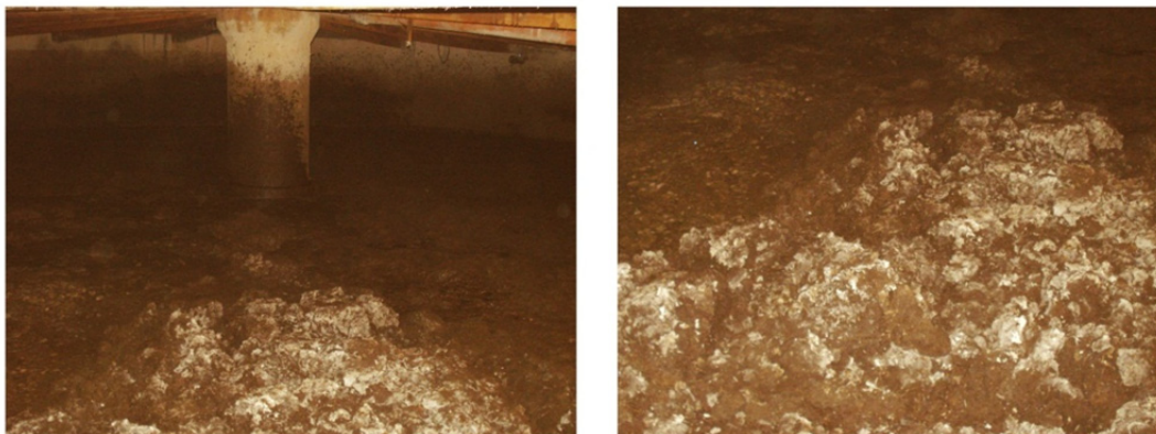
Obrázok 6 Príkrov v skladovacej nádrži vytvorený pri nedostatočnom miešaní Figure 6 Biomass sheet in a storage tank produced by insufficient mixing
