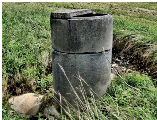
Foto 31: Drenážní šachtičky po místní přívalové povodně. Zdroj: Kvítek T.
