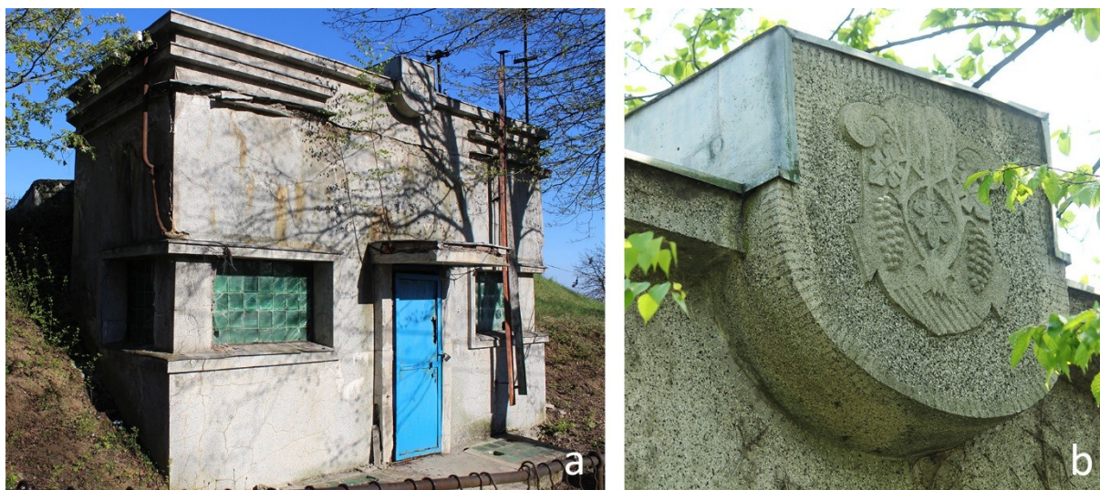
Obr.5: Súčasný stav budovy vodovodu: a) celkový pohľad; b) prvok fasády s erbom Užhorodu. (Foto: Lina Dehtáreva)
