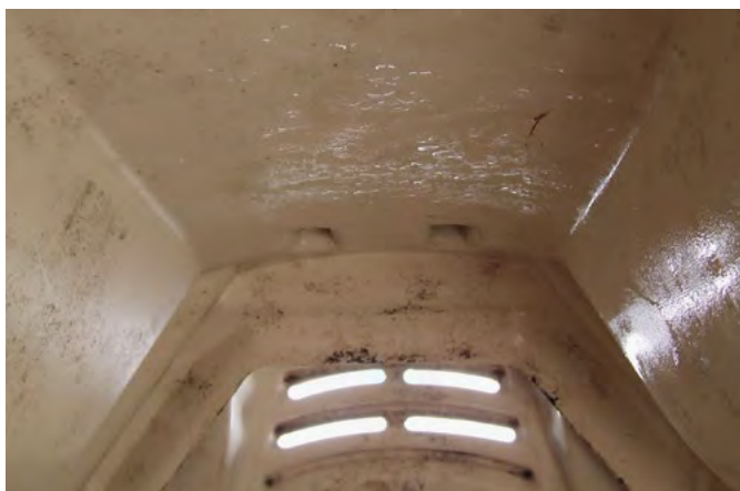
Obrázek 20: Kondenzace vodních par na vnitřních površích VIB ukazuje na nedostatečnou úroveň větrání.
