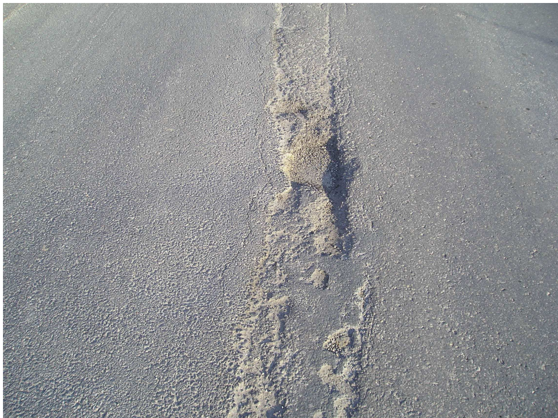
Foto 3: Stav komunikácii – mesto Turzovka časť predmier, smer Korňa a Klokočov
