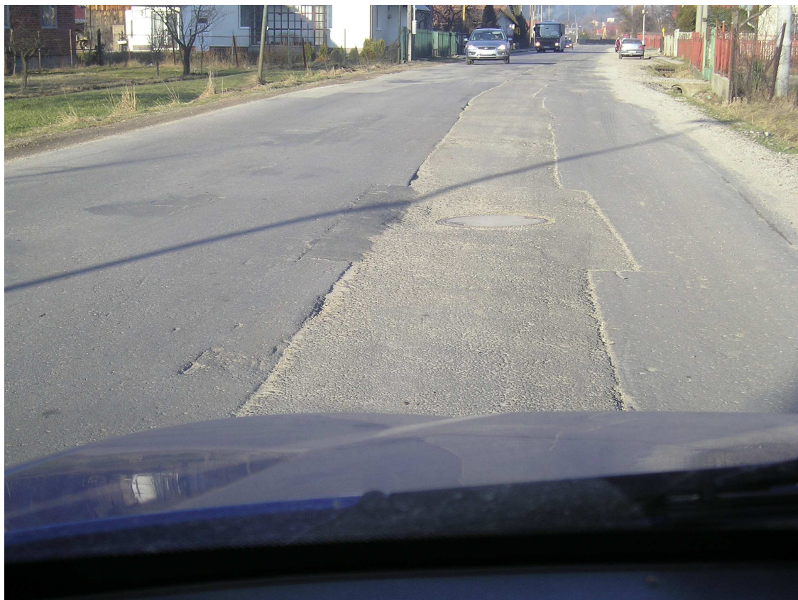
Foto 2: Stav komunikácii – mesto Turzovka časť predmier, smer Korňa a Klokočov
