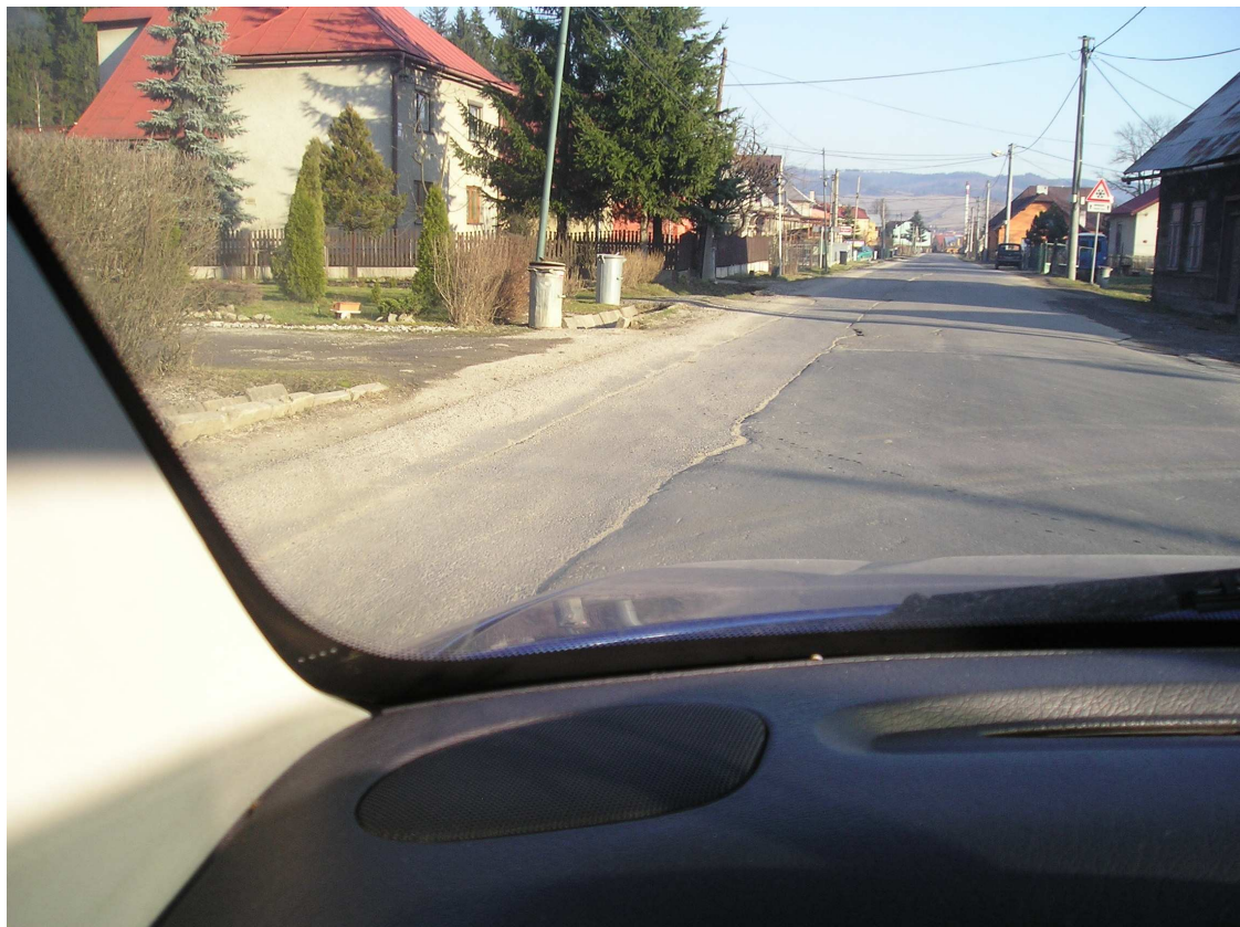
Foto 1: Stav komunikácii – mesto Turzovka časť predmier, smer Korňa a Klokočov
